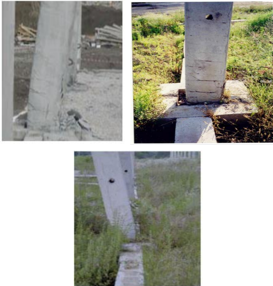
Şekil 1. Kolon-temel birleşiminde dolgu beton ezilmesi [8–10]
