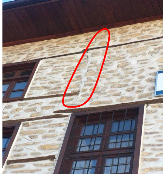
Şekil 16. Güney cephesindeki duvarda mevcut oluşan çatlak
