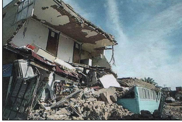
Şekil 3 Yığma duvarın düzlem dışı kırılması (Bam Depremi, 2004)
