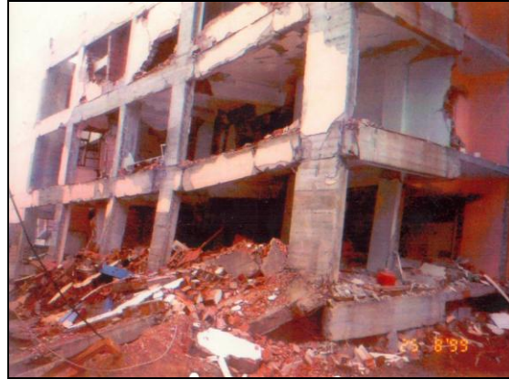
Şekil 2 Betonarme çerçevesel yapıda dolgu duvarların düzlem dışı kırılması
